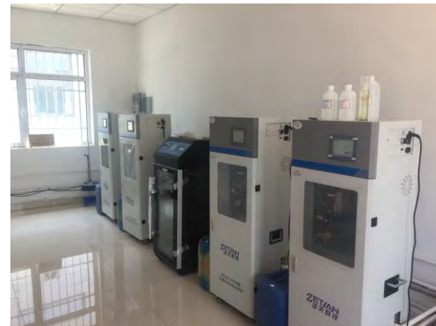
出水在线监控室（COD、NH 3 -N、TN、TP）
